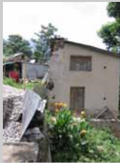
メラムチ給水プロジェクトにより半分取り壊された家屋（ネパール）
